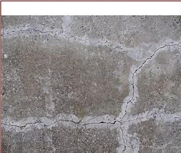
ASRによるクラック状況
