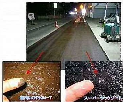
スーパータックゾールの分解状況
